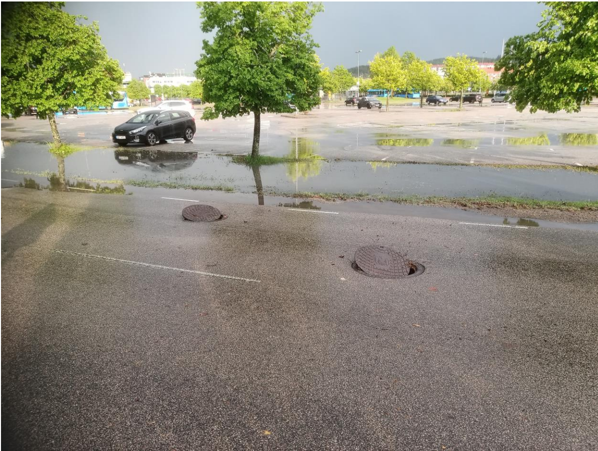
Figur 11. Brunnslock på dagvattenkylverten som har lyft på grund av övertryck inne i ledningsnätet. Foto Martin West.
