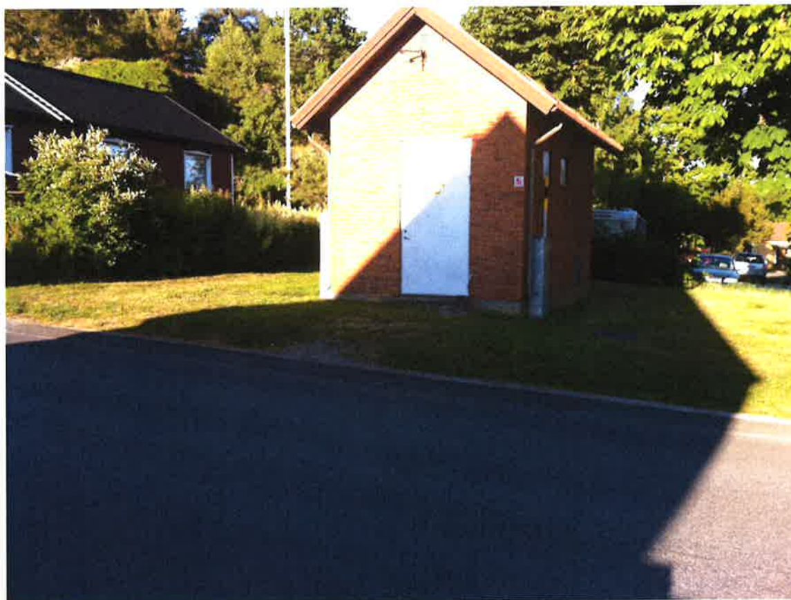
Befintlig transformatorstation sedd från sydväst. Intill norra och södra fasaderna finns kopplingskåp.
