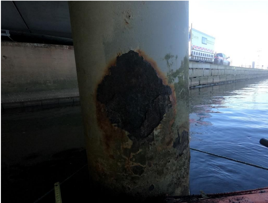
Figur 5. Bild på korrosionsskada från AFRYs inspektion 2023.
