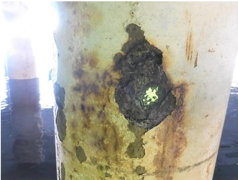
Figur 4. Bild på korrosionsskada från AFRYs inspektion 2023.
