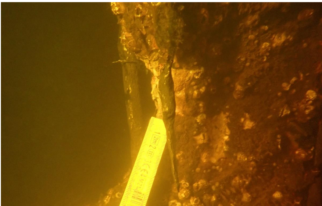
Figur 6. Bild på spjälkning på stödmur, AFRY 2023.
