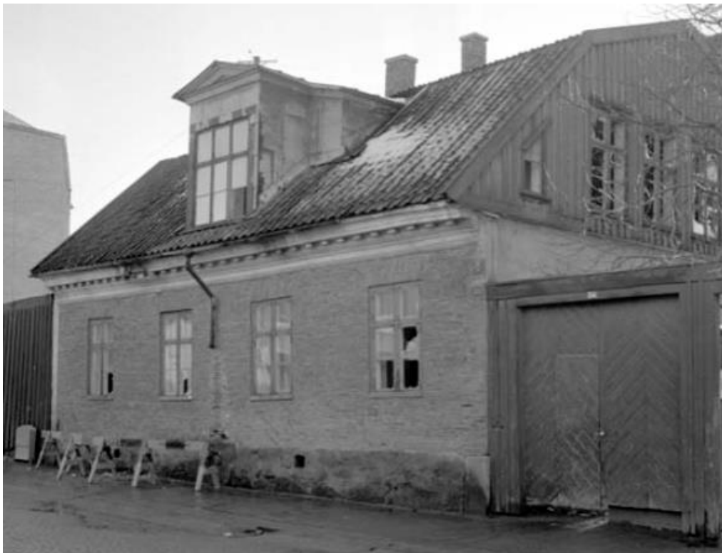
Enligt foto från 1959 hade takutsprångets listverk en tandsnittsfris vilken troligen finns kvar (i dåligt skick) under den senare tillkomna plåtinklädnaden. Källa: Bohusläns museums arkiv.
