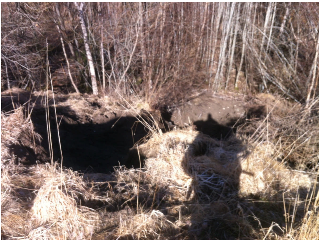
Figur 4 Foto från släntkrön ned mot ytligt skred.
