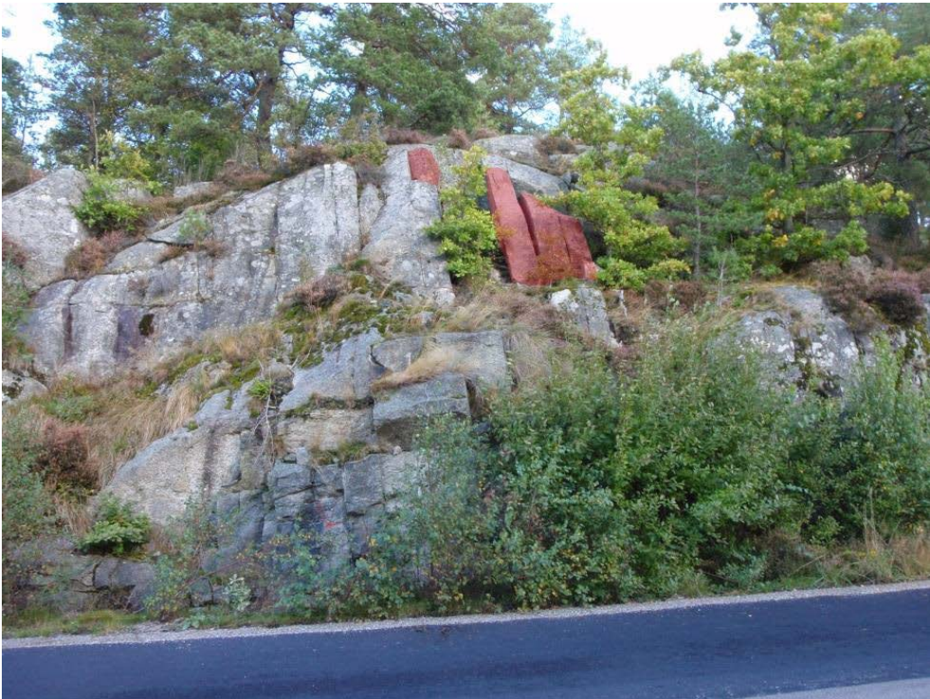
Högsta delen av skärning C belägen ca 15 m från dess sydliga slut. Block som bedöms vara rasbenägna har markerats i rött. Vy åt ONO. Foto: Norconsult
