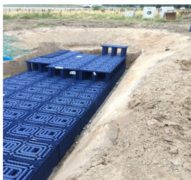
Dagvattenmagasin med plastkassetter (Torp)
