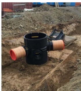
Dagvattenbrunn med sandfång som används i Sundsstrand
