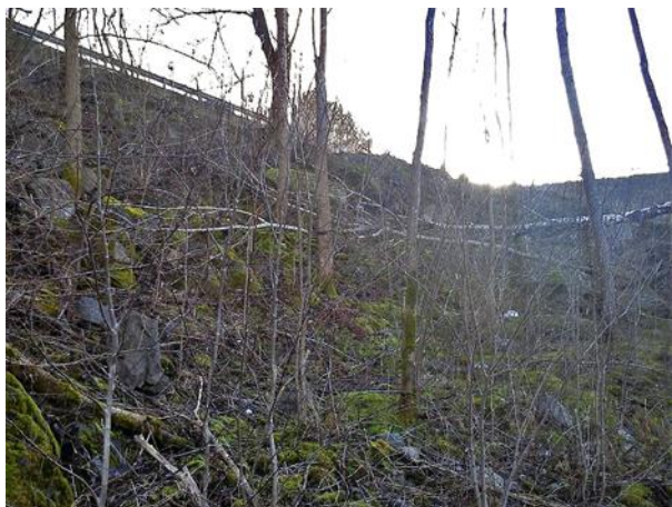
Bilden visar en sprängstensslänt i sydvästra delen av planområdet med en del lösa block.
