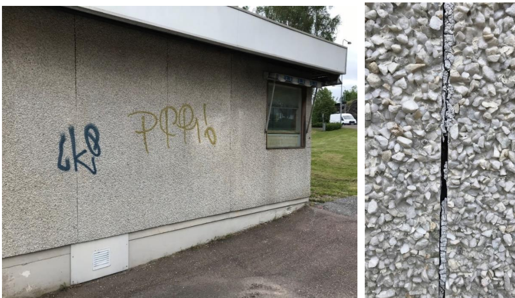
Figur 5. Den södra väggen på nuvarande hus på fastighet Klubban 3. I skarvarna mellan fasadplattorna fanns fogmassa som provtogs.
