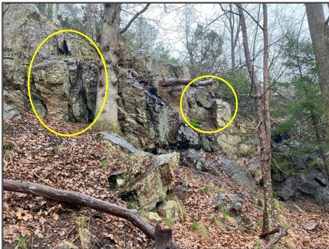
Figur 11. Slänt med uppsprucket berg i mitten av det norra delområdet. Sprickriktningarna ger upphov till skivor vilka ställvis saknar bottenstöd.
