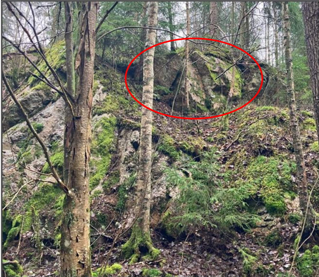
Figur 4. Berget i det sydvästra delområdet är ställvis uppsprucket. Block inringade i rött visar exempel på potentiellt instabila block där rot- och frostsprängning riskerar att skapa utfall över tid.
