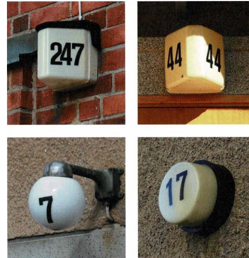
Armaturer som även redovisade numret på uppgången.
