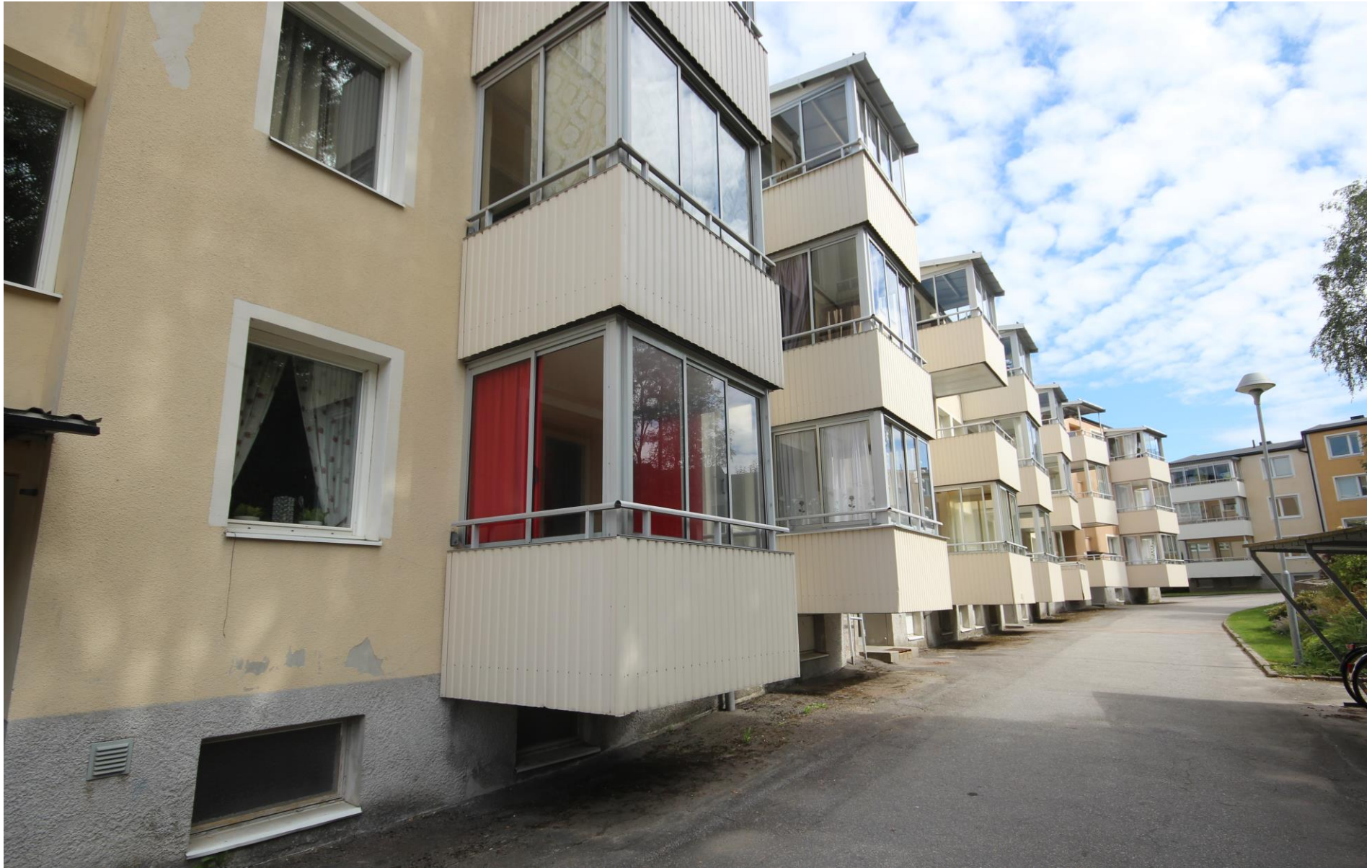
Balkongerna är utbytta och har ett helt annat utförande än de ursprungliga. Plattor, räcken och fronter är sekundära och flertalet balkonger är inglasade.
