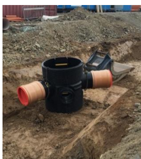
Dagvattenbrunn med sandfång som används i Sundsstrand
