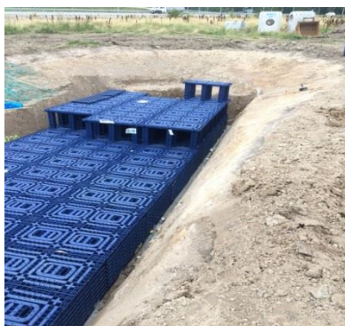
Dagvattenmagasin med plastkassetter (Torp)
